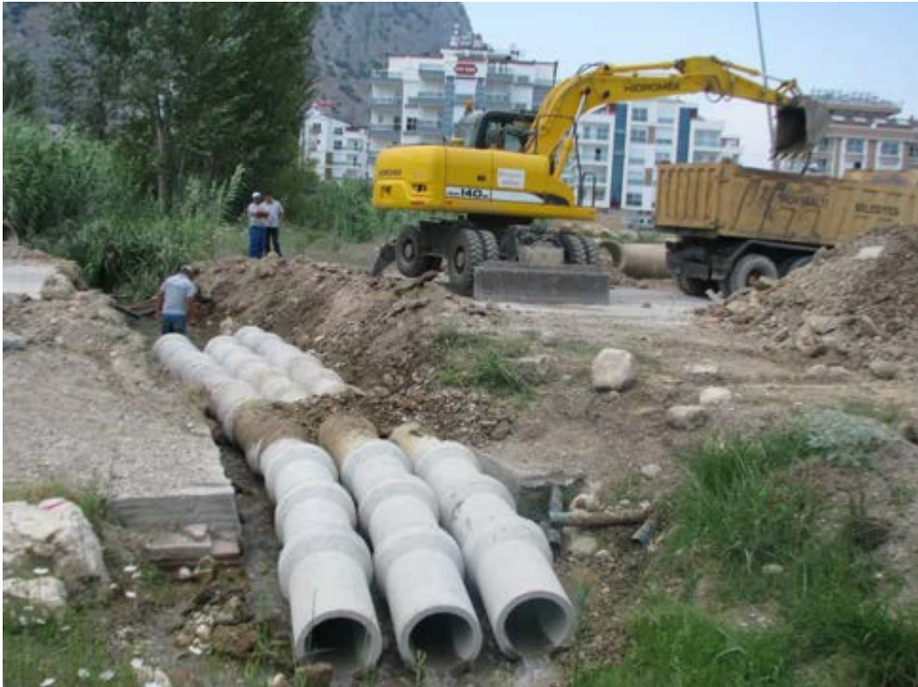
Hurma Mahallesi 195 Sokak dere geÇiÇeri
